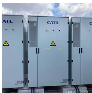
Batteriespeicher 6 MW / 7.58 MWh
